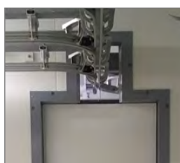
Passage de rail de manutention
